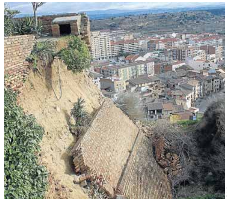
El Ayuntamiento realizó gestiones por el derrumbe de un muro.
