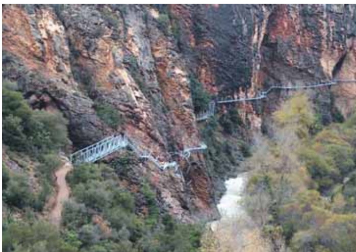
Imagen de las pasarelas desprendidas por efecto de las lluvias.
