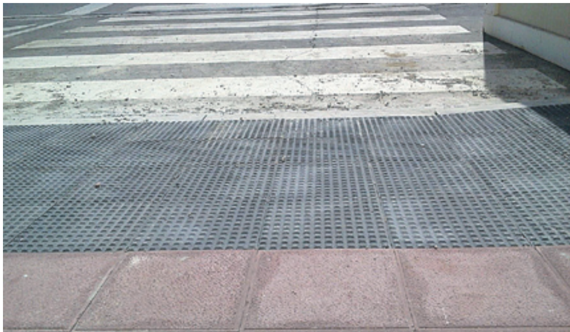
Rebaje en una acera realizado en la calle San Jorge. J.A.T.
